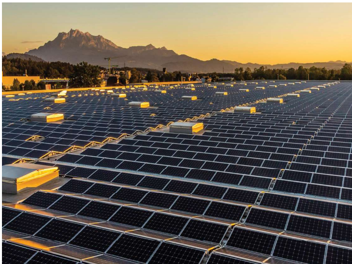
1 Verteilzentrum ALDI SUISSE AG in Perlen/LU, Schweizer PlusEnergieBau-Solarpreis 2020.
