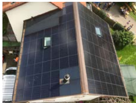
2 Die perfekt dachintegrierte 14.6 kW PV-Anlage des EFH Wehrli erzeugt 14'700 kWh/a.
