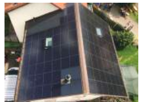
2 Die perfekt dachintegrierte 14.6 kW PV-Anlage des EFH Wehrli erzeugt 14'700 kWh/a.
