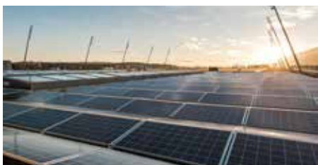
L'installation PV intégrée au stade solaire Tissot à Bienne produit environ 2,1 GWh/an.
