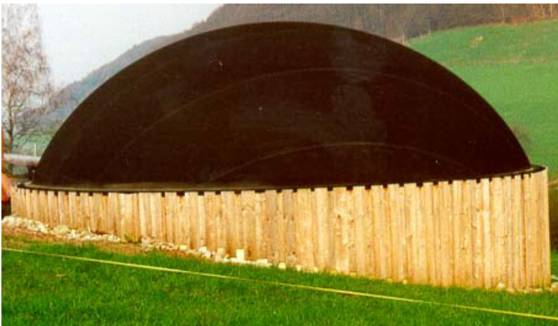
Kompakt-Biogasanlage: Fermenter 400 m 3 ø 10 m, Gasfolienhaube 100 m 3 (schwarz, oben)
